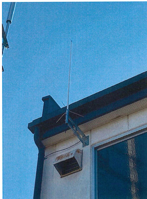
防災無線機通信アンテナ
