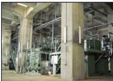
①沈砂池設備
