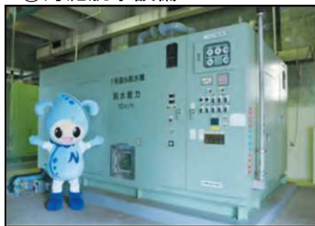
⑪汚泥脱水設備
