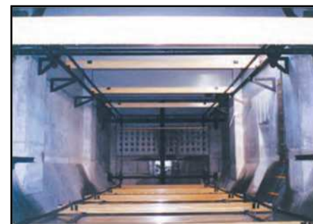
⑥最終沈殿設備
