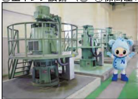
②主ポンプ設備 (②-④標高差16m)
