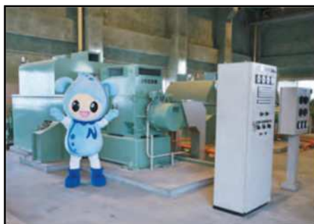
③送風既設備
