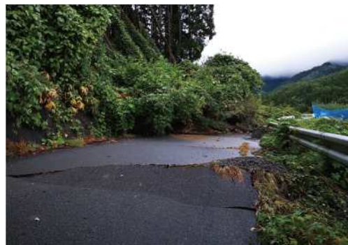
令和元年東日本台風災害の被災状況 道路法面崩落災害
