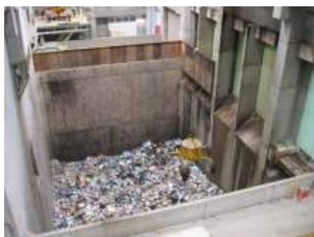
市資源再生センター不燃ごみピット
