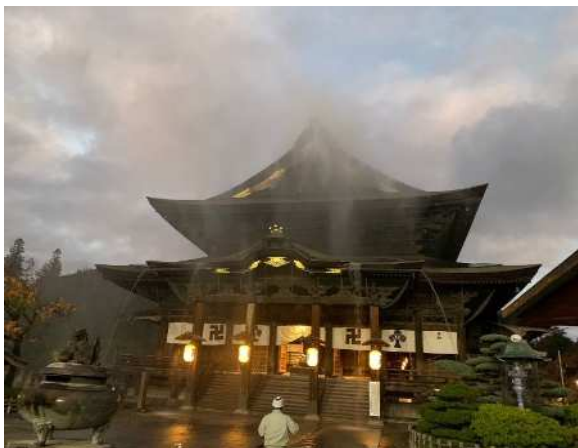
本堂 ドレンチャーの放水試験
