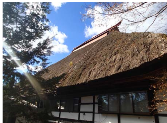
屋根 (木が生えてしまっている)
