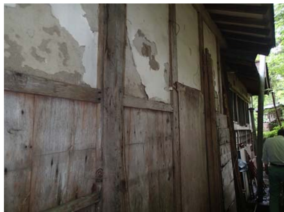
外壁(漆喰の破損)
