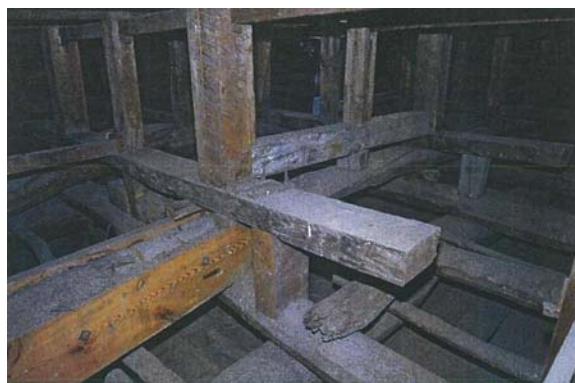
小屋組の破損状況
