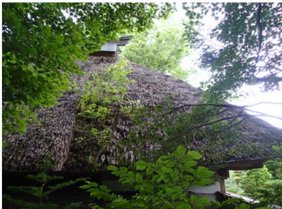
屋根 (木が生えてしまっている)
