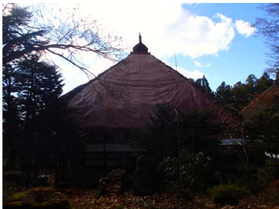
屋根 (痛みが激しいためシートで保護)
