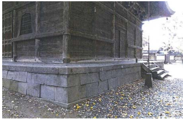
基壇の破損状況(西面)
