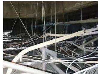
電気設備の老朽化・残置
