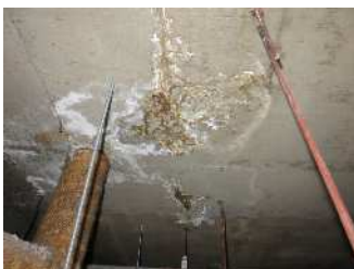
躯体の劣化に伴う雨漏り
