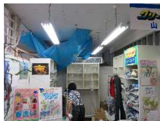
給排水管からの漏水
