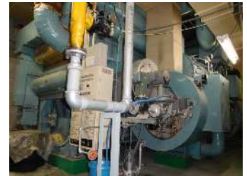
撤去困難な機械設備
