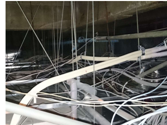
電気設備の老朽化・残置
