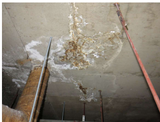
躯体の劣化に伴う雨漏り
