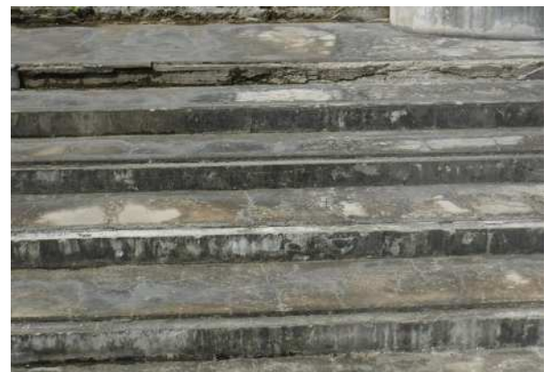
正面階段の劣化(ひび割れ、欠け)
