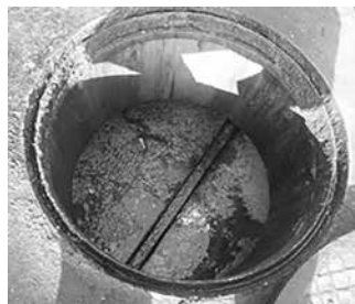
▲油で汚れたグリーストラップの内部
