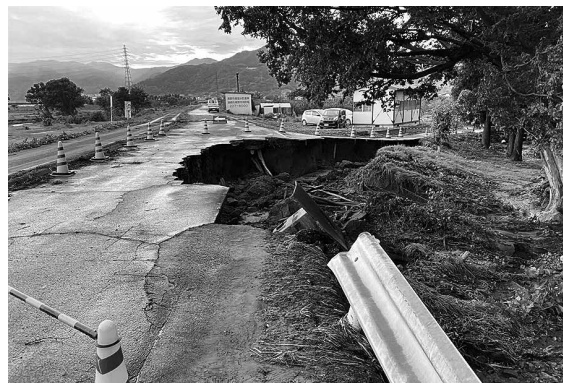
篠ノ井地区の堤防道路被災現場
