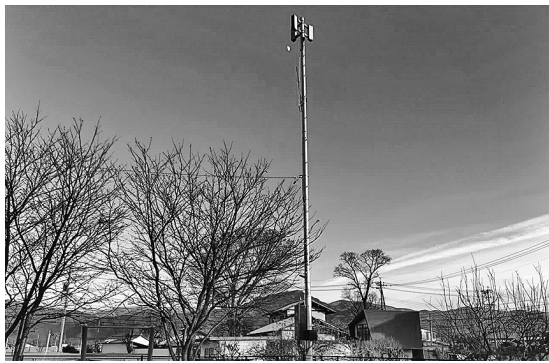
デジタル化整備により高性能スピーカーを取り付けた防災行政無線
