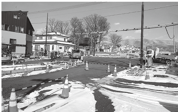
開通に向けて工事が進められている都市計画道路高田若槻線
