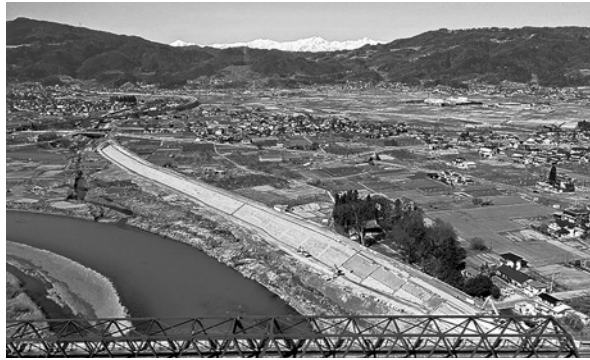
令和元年東日本台風でのり面が欠損した堤防の復旧工事（篠ノ井塩崎）
