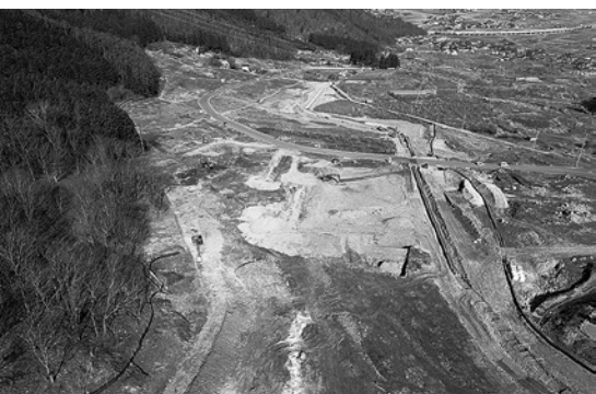
営農の効率化のために圃場の集約・集積を行う基盤整備事業（若穂地区）
