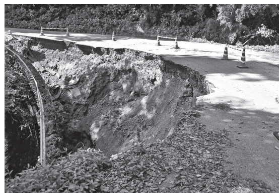
8月の豪雨による被害（中条地区）
