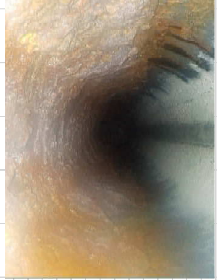
内部腐食状況(芹田3号幹線)
