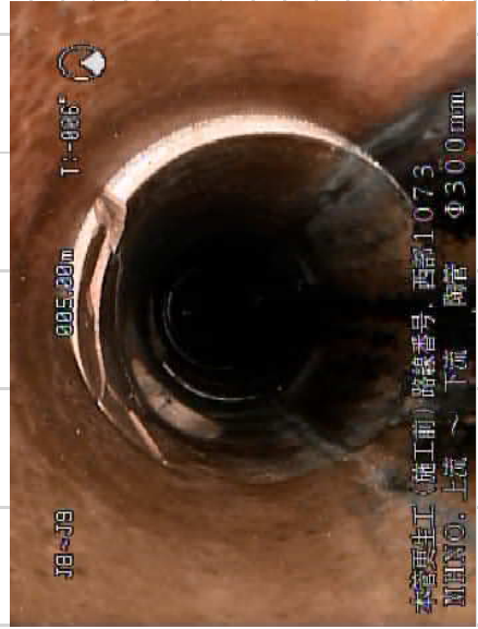
破損状況(西部処理分区)
