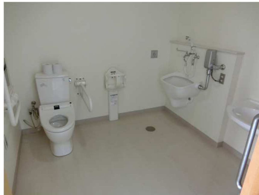
(8) 保倉体育館内部多目的トイレ(上越市)
