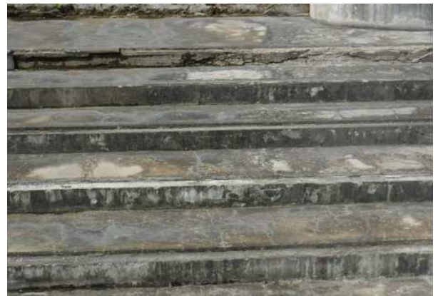
正面階段の劣化(ひび割れ、欠け)
