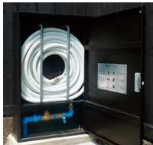
(参考) 易操作性消火栓の設置例 (八女市八女福岡 伝建協ホームページより) https://www.denken.gr.jp/outline/prevention.html
