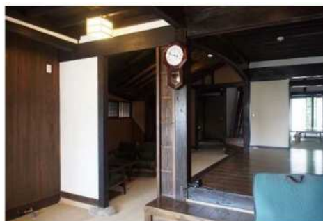
荒壁パネルによる補強壁の例 (鹿島市浜庄津町浜金屋町地区)
