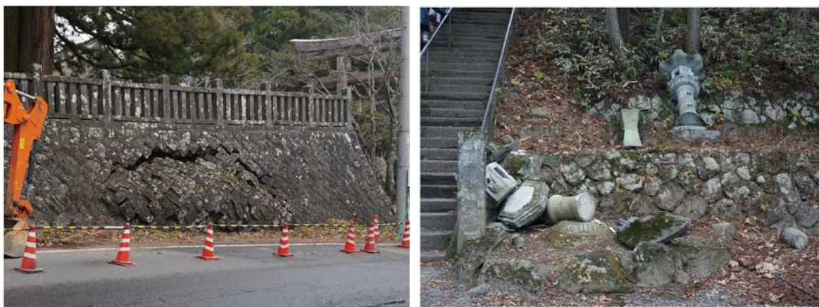
長野県神城断層地震による石垣と石造物の被害状況
