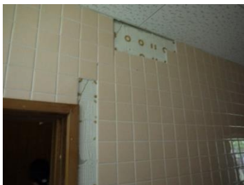
・ タイル剥離 (トイレ)
