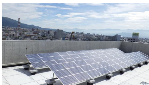
太陽光発電設備
