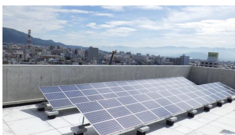
太陽光発電設備
