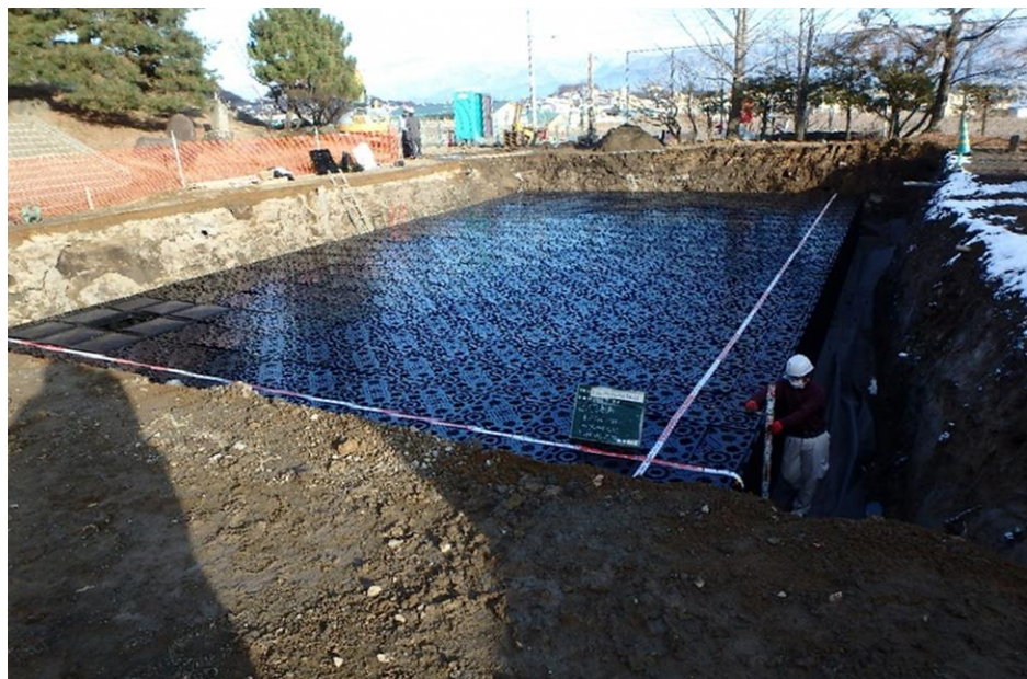
豊野西小学校校庭 地下貯留施設
