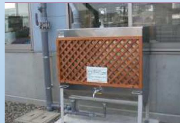
雨水貯留タンク 公共施設
