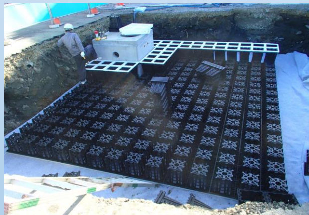
地下浸透貯留 中条総合市民センター
