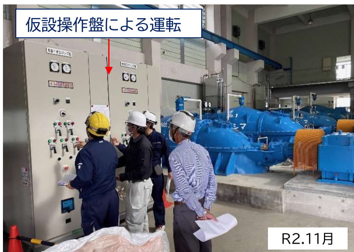
<長沼排水機場>
