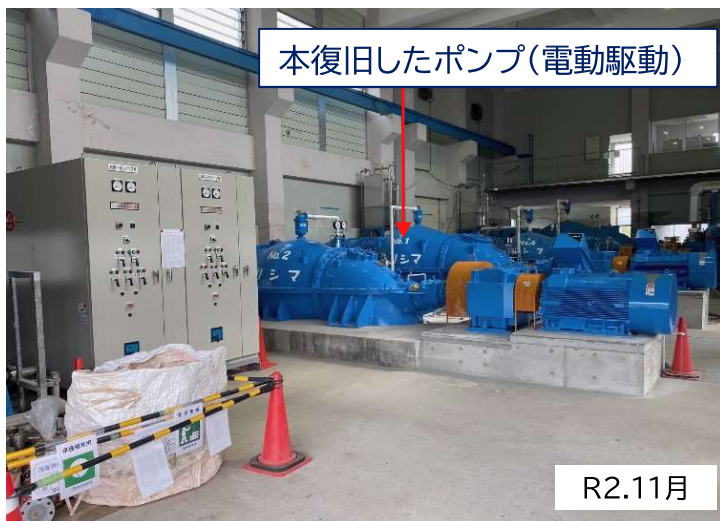
<長沼排水機場>
