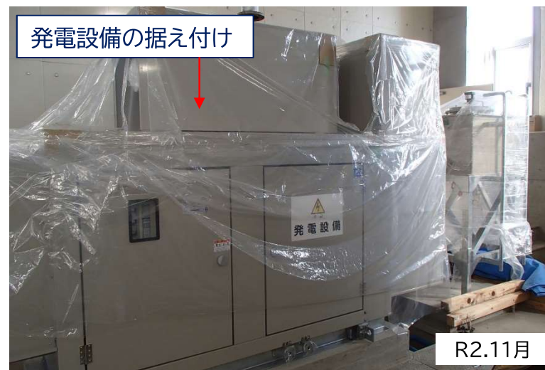
<三念沢雨水ポンプ場>
