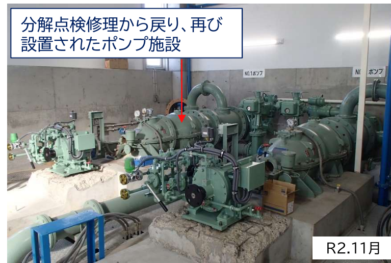
<三念沢雨水ポンプ場>
