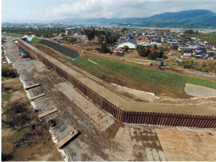
千曲川堤防の決壊現場で、仮堤防（中央左）を守るように造られた締切堤防（手前）は30日午前10時38分（河川管理者などの承諾を得て小型無人機で撮影）
