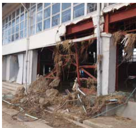
被災した長沼体育館
