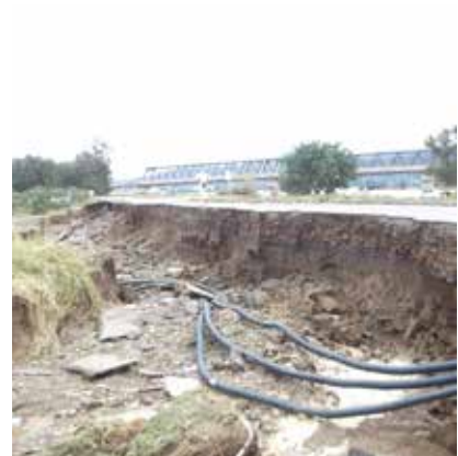
千曲川の越水により破損した篠ノ井塩崎の堤防
