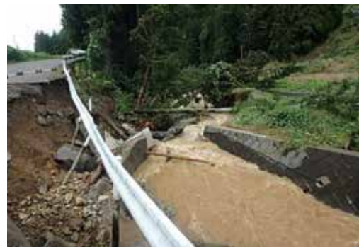
音坂高岡線(若穂保科)被災後
