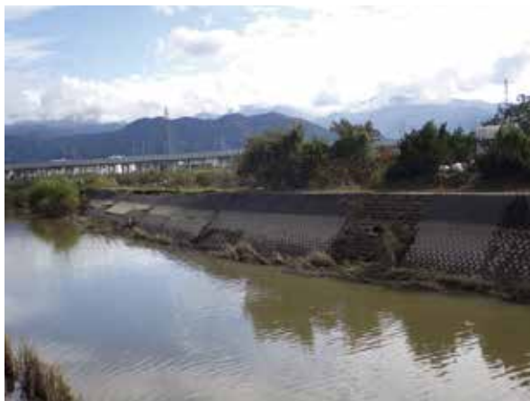
浅川被災状況(豊野地区)
