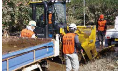
長野県建設業協会各支部による土砂撤去(新建新聞社提供)
