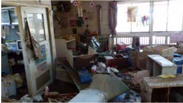
豊野みなみ保育園の被災状況
