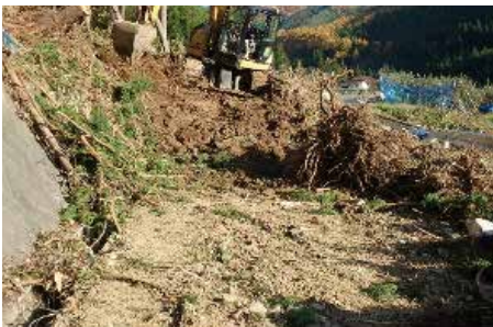
崩落土撤去状況
