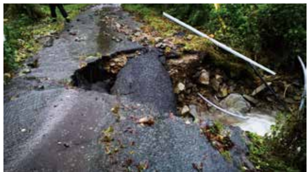
路面の陥没(若穂保科)
