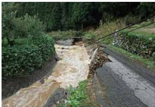
音坂高岡線(若穂保科)被災後
