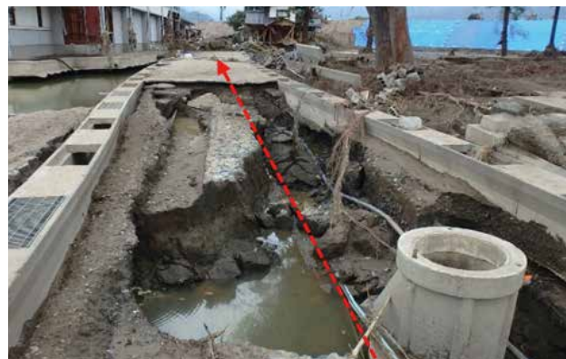
水道管の破裂 (穂保)
