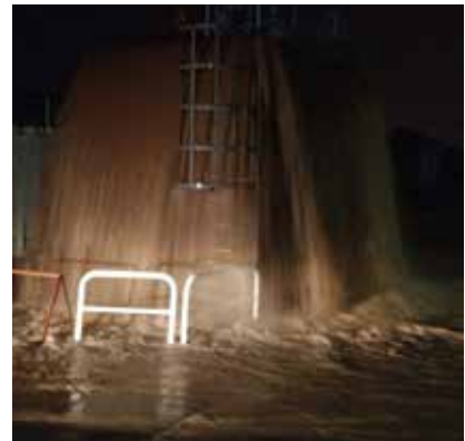
小森第二排水機場からあふれる大量の水
