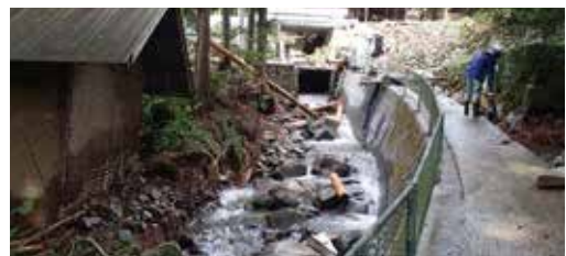
若穂高岡川被災状況
