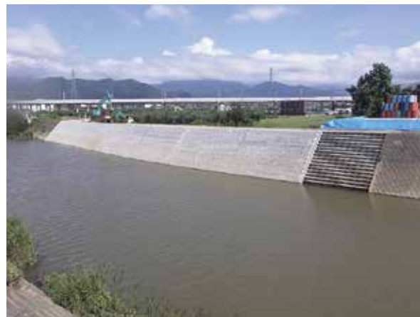
浅川復旧状況(豊野地区)
