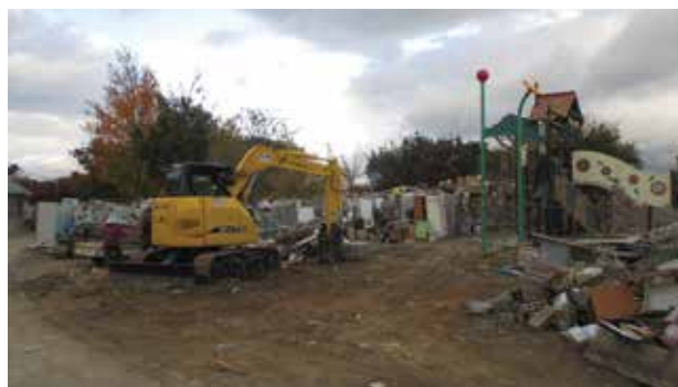
災害廃棄物仮置場としても機能（赤沼公園）
