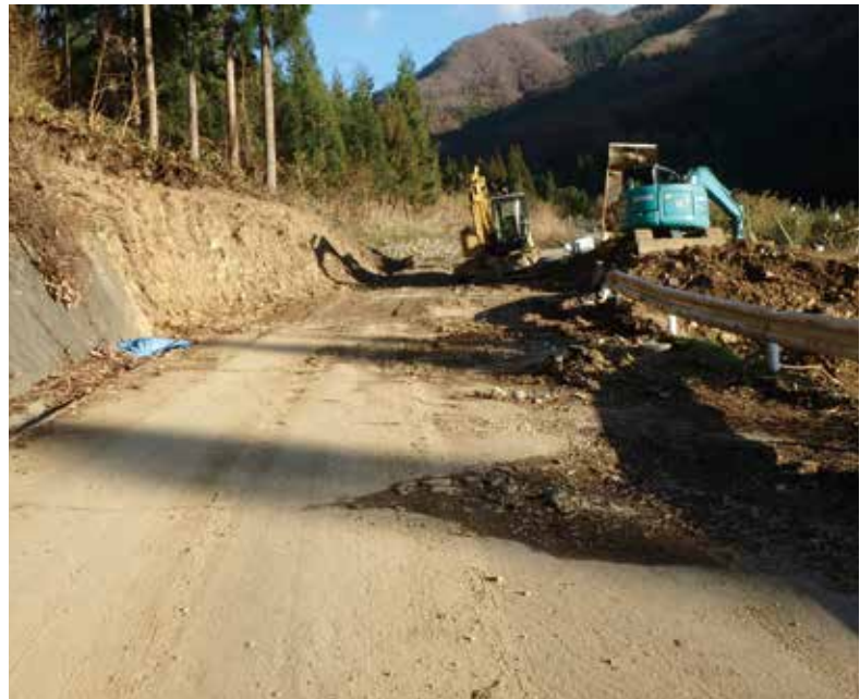
崩落土撤去状況
