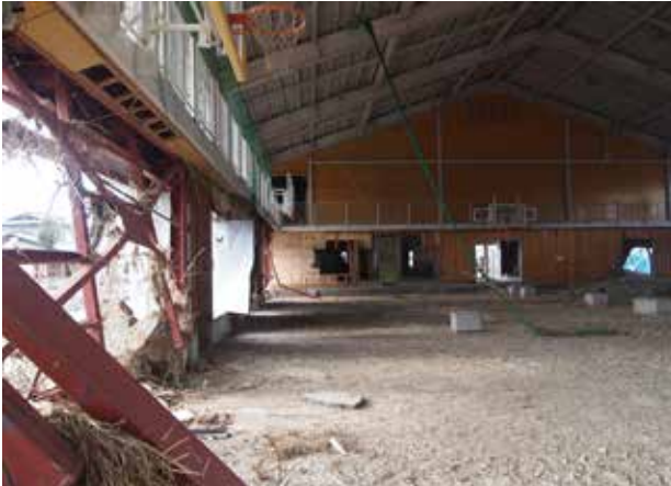
堤防決壊箇所に近い長沼体育館
