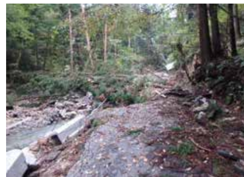
県道長野菅平線(若穂保科)被災後
