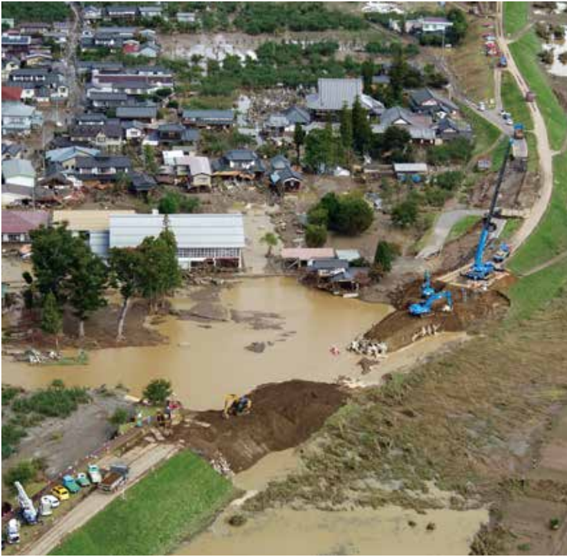
復旧工事が急ピッチで進む穂保(長沼地区)の千曲川堤防の決壊現場 (令和元年10月15日10時17分、信濃毎日新聞社提供)
