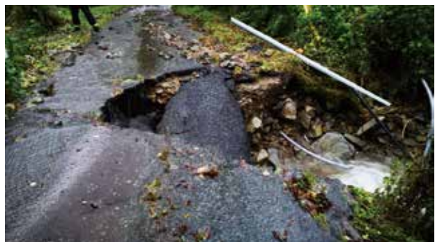
路面の陥没(若穂保科)
