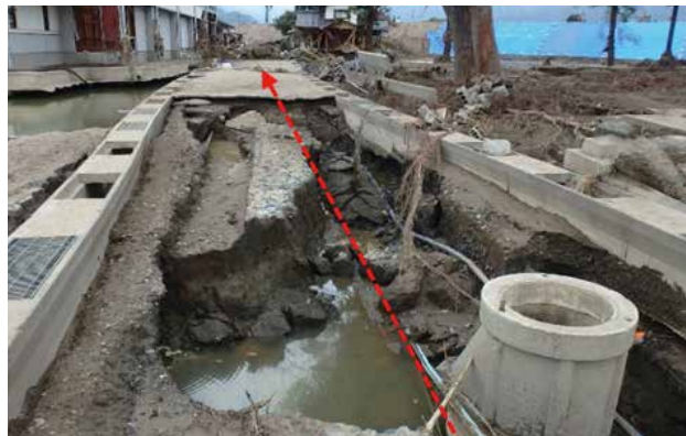
水道管の破裂 (穂保)
