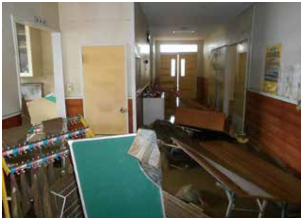
被災直後の長沼児童センター玄関ホール(令和元年10月17日)
