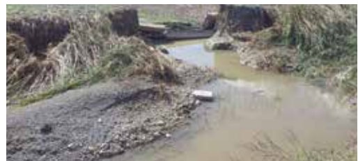
三念沢被災状況
