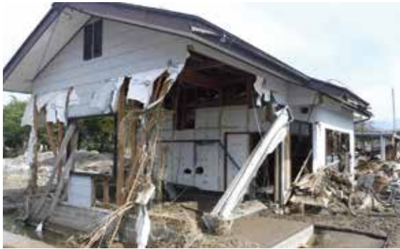
被災した長沼分団詰所
