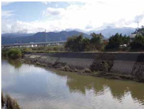
浅川被災状況(豊野地区)
