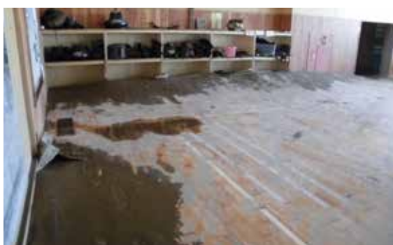
被災直後の武道場
