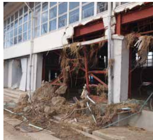
被災した長沼体育館
