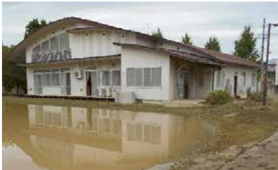
被災直後の建物全景、手前は松代小学校校庭(令和元年10月14日)
