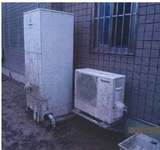
エコキュート交換前
