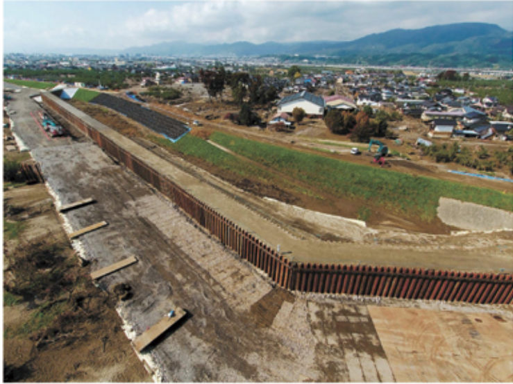
千曲川堤防の決壊現場で、仮堤防（中央左）を守るように造られた締切堤防（手前）は30日午前10時38分（河川管理者などの承諾を得て小型無人機で撮影）
