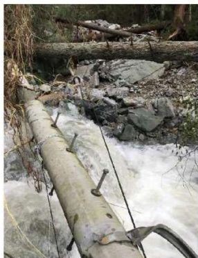
豪雨による道路状況
