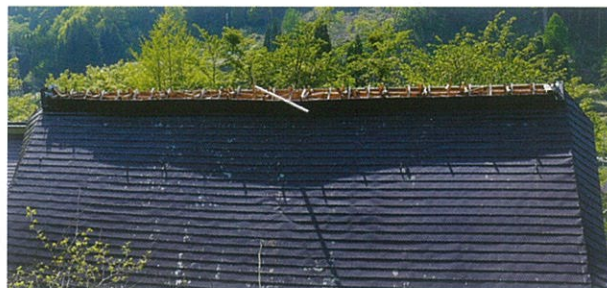
写真1 大棟が崩落した文珠堂の屋根
