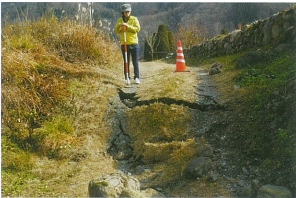
農道の坂に生じた亀裂。断層崖だということが判明
