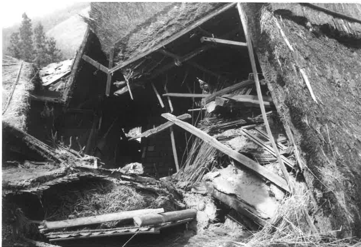
図1 松代町（現長野市）東部家屋の被害。長期間にわたる揺れで多くの建物が被害を受けた。（画像提供：松代地震センター）
