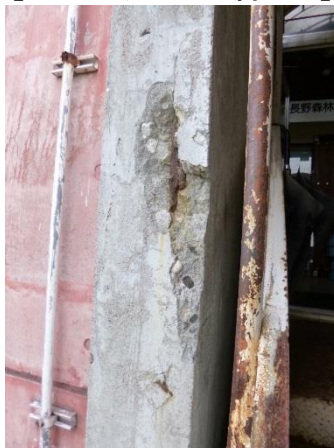
【コンクリートの剥がれ】
