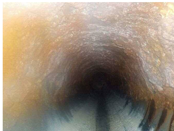
腐食が進んだ管渠内部（芹田 3 号污水幹線）
