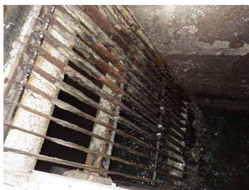
機械設備（東部浄化センター沈砂池設備）
