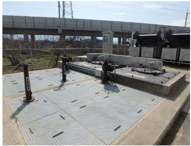
吐出弁及び雨水ポンプ状況
