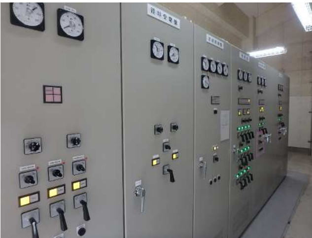
操作盤設置状況
