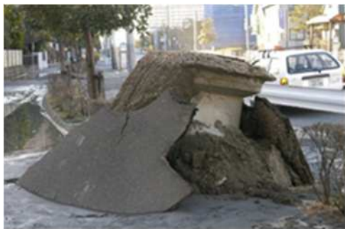
地震によるマンホールの浮上(千葉県浦安市)
